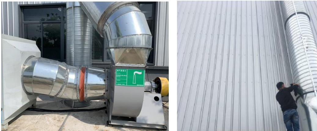
废气处理设施
